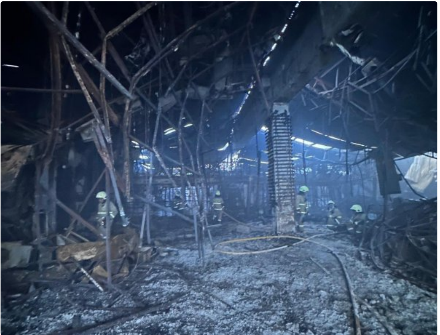
Glodok Plaza yang Hangus Terbakar
